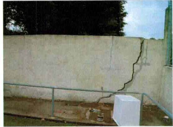
Foto 04_Vista muro de cierre agrietado.
