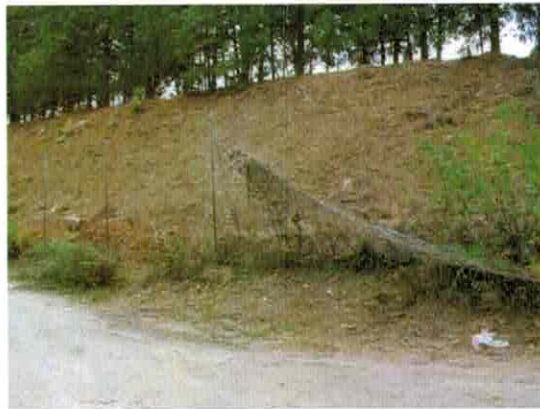
Foto 03_Vista cierre metálico en mal estado.
